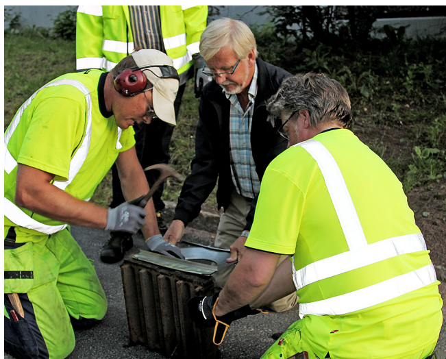
Gilbert Svensson ger en hjälpsam hand vid installationen av filter i dagvattenbrunn i projekt Vitsippsbäcken.
